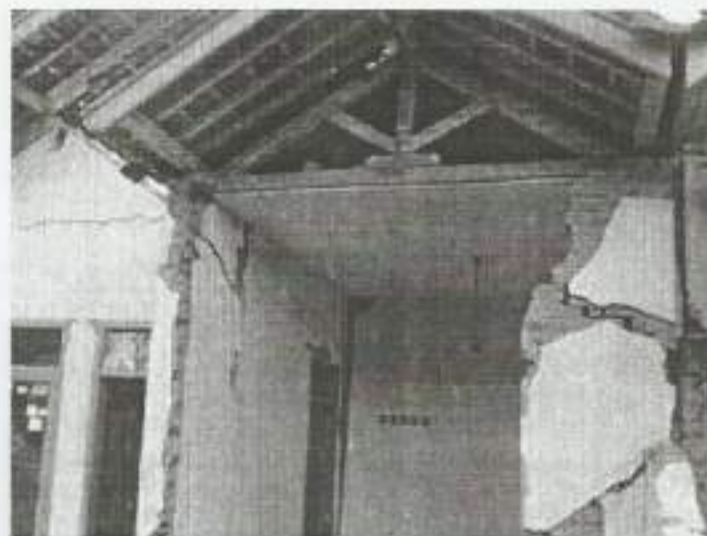
Gambar 6. Kerusakan pada bangunan yang strukturnya kurang baik
