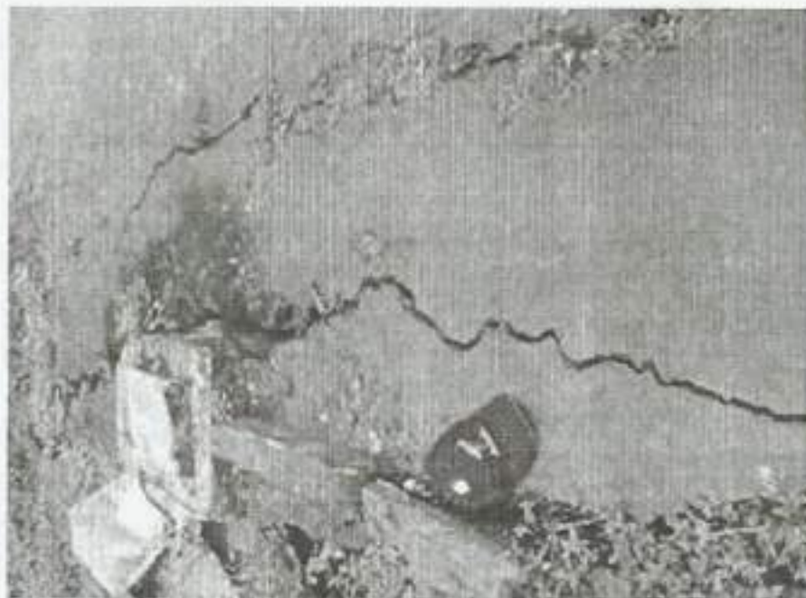
Gambar 10. Retakan tanah yang merusak jalan raya di Desa Jaya Pura.
