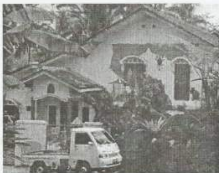
Gambar 7. Kerusakan pada bangunan yang strukturnya cukup baik
