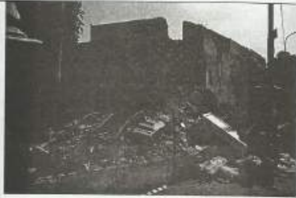
Gambar 3. Salah satu bastion di Pojok Benteng Kraton Yogyakarta bagian barat daya runtuh (Dok. Bp3 DIY)
