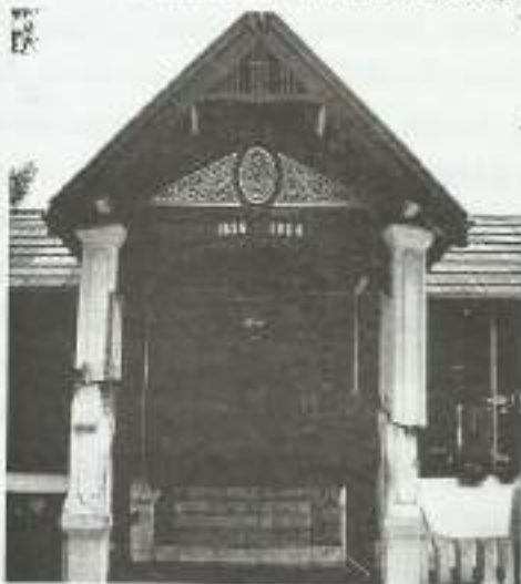
Gambar 5. Kolom kuncungan Masjid Mataram Kotagede mengalami patah (Dok. BP3 DIY)
