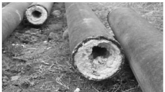
Gambar 1 Scaling silika pada jalur injeksi brine di lapangan panas bumi Dieng [3]
