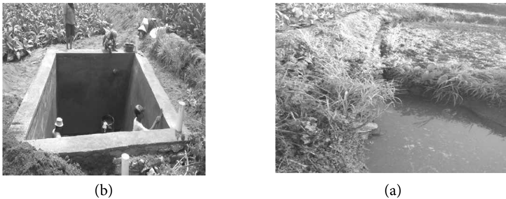
Gambar 3 (a) Titik Embung di Srunggo 1 sebelum Dibangun dan (b) Proses Tahap Akhir Pembangunan
