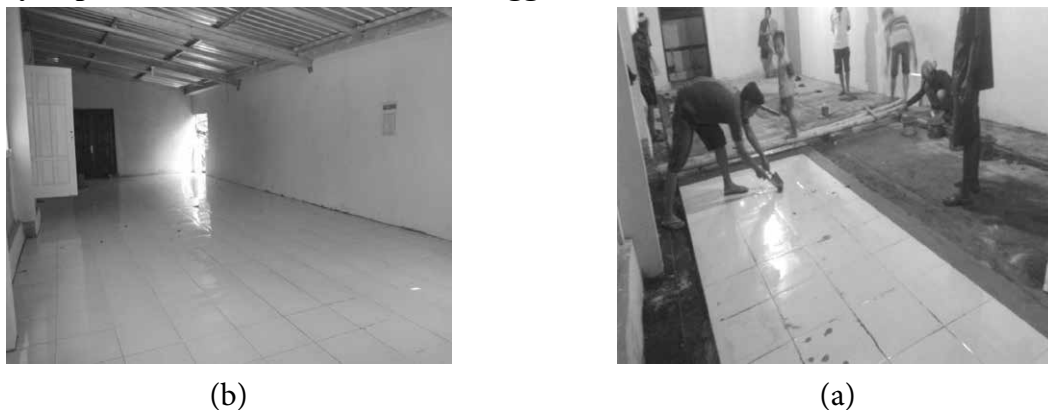
Gambar 4 (a) Proses Pemasangan Keramik di Rumah Pintar di Srunggo 1 dan (b) Kondisi Ruangan setelah Dikeramik
